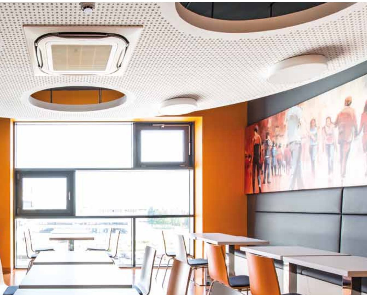
Designhotel im neuen MSC 2 : Den gestalterisch hohen Ansprüchen muss auch der Trockenbau Rechnung tragen, wie hier im Frühstückraum die abge- hängte, elliptische Decke mit akustisch wirksamer Lochdecke.
